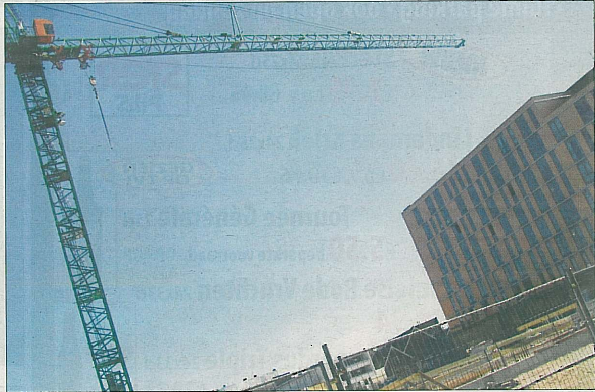
Met een enorme bouwkraan als zichtbare baken komt de geplande oplevering in juli 2012 letterlijk al in zicht. FOTO ADDO SPRANGERS
